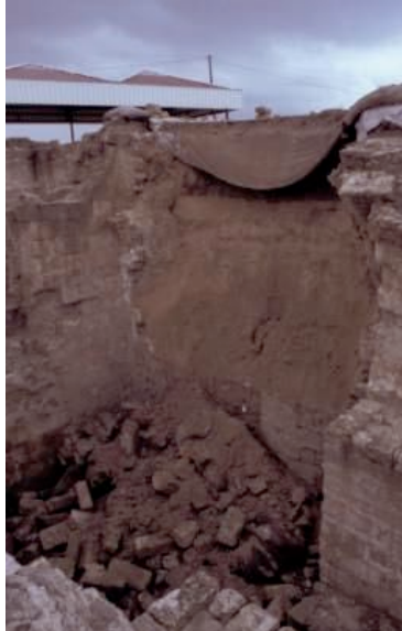
Photo 3 : Un mur restauré après un épisode pluvieux
